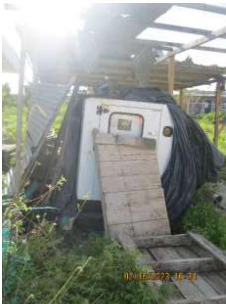
Foto 5. Equipo a la intemperie
