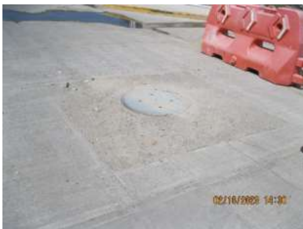
Foto 39. Deficiente terminación Pozo de inspección
