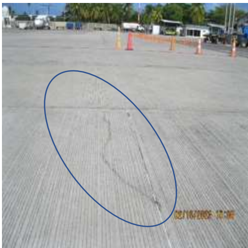
Foto 56. Grieta de esquina,
