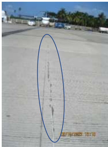
Foto 69. Corte de junta de dilatación con parche en sello de junta y con desportillamiento
