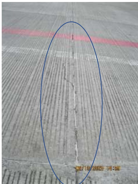
Foto 48. Grieta desde junta de dilatación,
