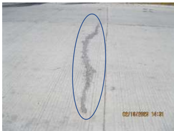
Foto 40. Fisuras transversales, con parcheo
