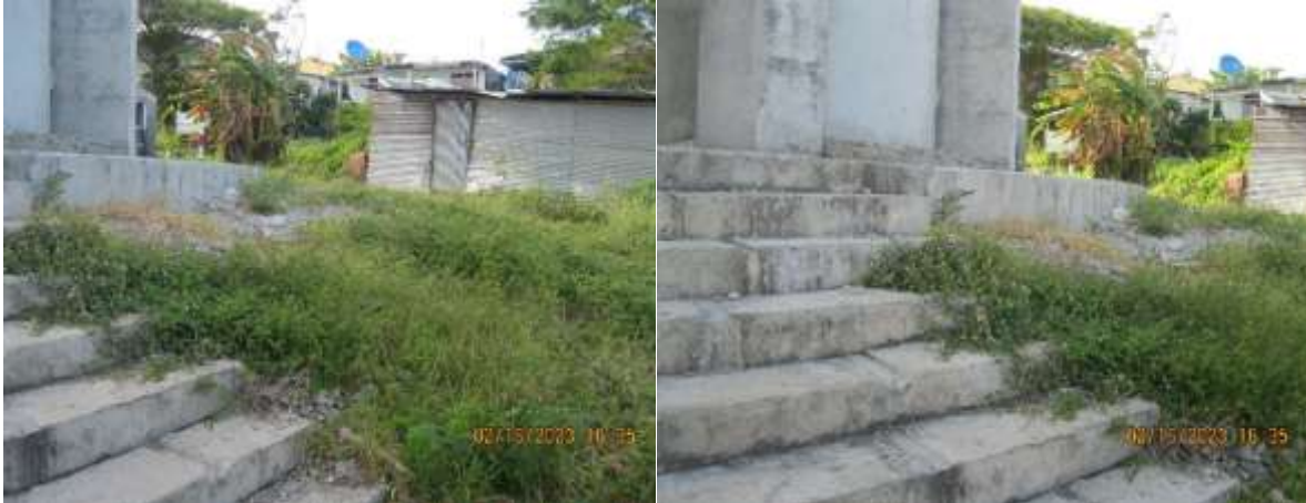
Fotos 3 y 4. Escalera con maleza
