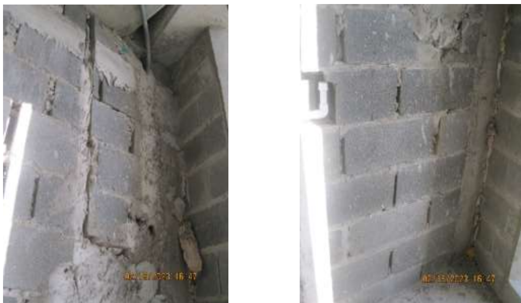
Fotos 25 y 26. Mampostería con deficiente acabado, juntas de pega inexistentes en algunos espacios y con exceso en otras
