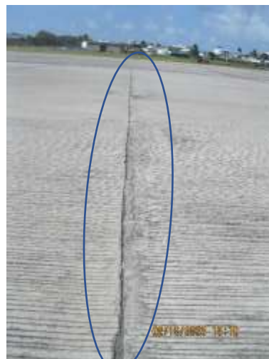
Foto 57. Junta de dilatación, ausencia de sello de junta y fraccionamiento
