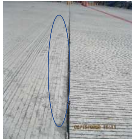
Foto 63. Junta de dilatación, sin sello de junta
