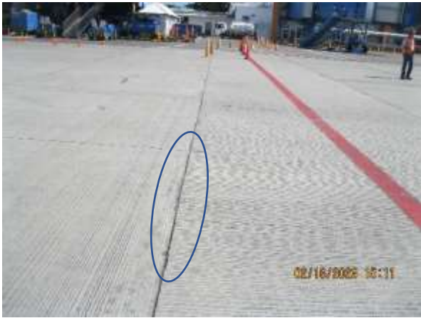
Foto 62. Junta de dilatación, sin sello de junta
