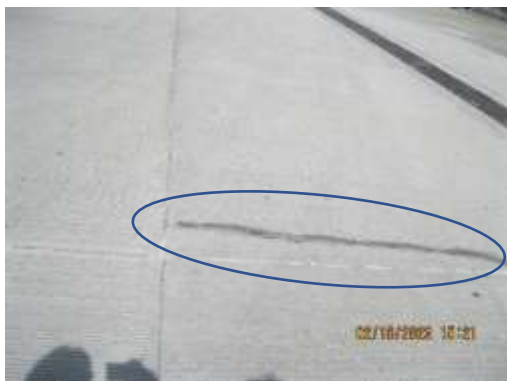
Foto 72. Grieta de esquina con parche
