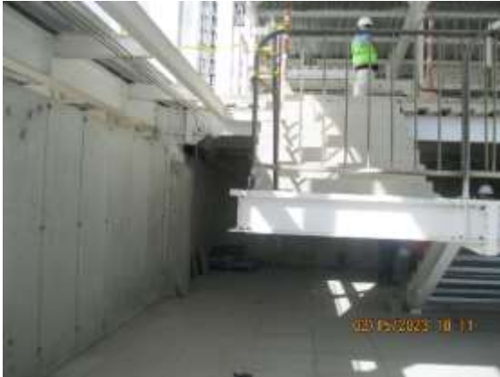
Foto 75. Acceso hacia escalera y ascenso sin terminar
