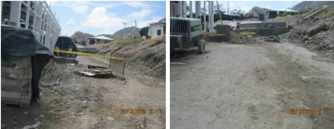
Fotos 86 y 87. Tramo peatonal sin terminar y sin confinamiento de talud.
