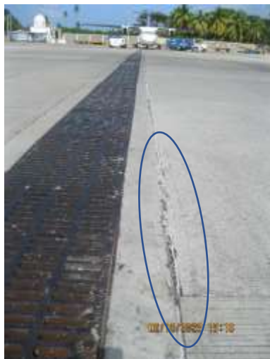
Foto 68. Junta de dilatación con pérdida de sello de junta y con desportillamiento
