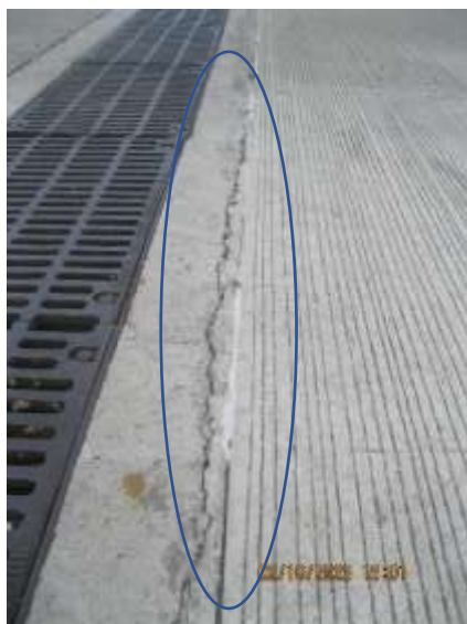
Foto 50. Grieta desde junta de dilatación, en viga de estructura de drenaje
