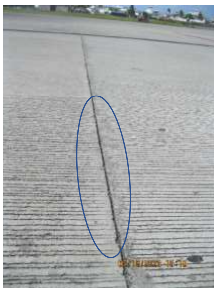
Foto 60. Junta de dilatación, sin de sello de junta
