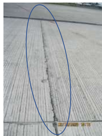
Foto 67. Junta de dilatación sin sello de junta y con desportillamiento.
