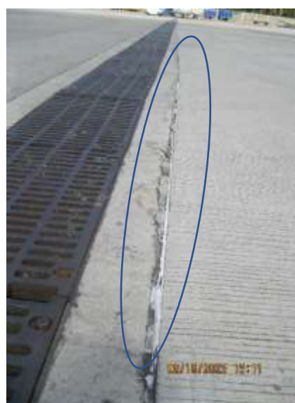
Foto 61. Junta de dilatación, en viga de estructura de drenaje con pérdida de sello y daño por desportillamiento.
