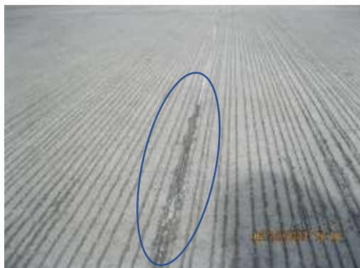
Foto 58. Junta de dilatación, pérdida de sello de junta
