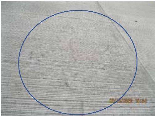
Foto 52. Fisuras ligeras de aparición temprana
