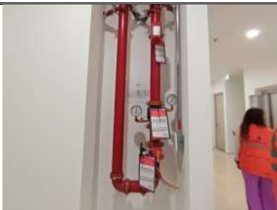
28. Falta terminados de red contraincendios.
