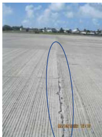
Foto 71. Junta de dilatación con desportillamiento alto
