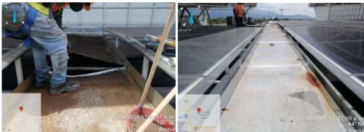
Imágenes 3. Estado cubiertas terminal de pasajeros y torre de control
