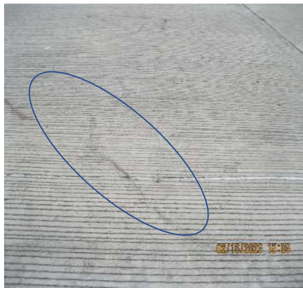
Foto 51. Fisura transversal en dos placas seguidas con junta de dilatación mínima
