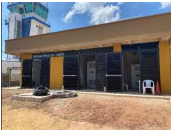
Subestación eléctrica sin energizar
