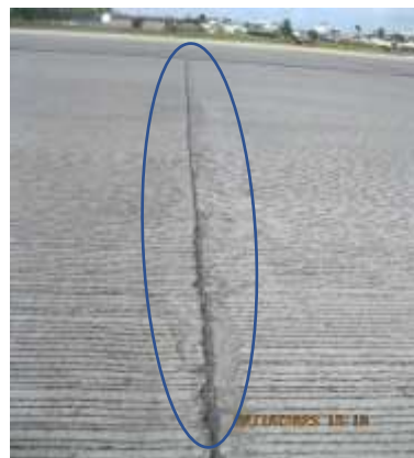
Foto 59. Junta de dilatación, pérdida de sello de junta
