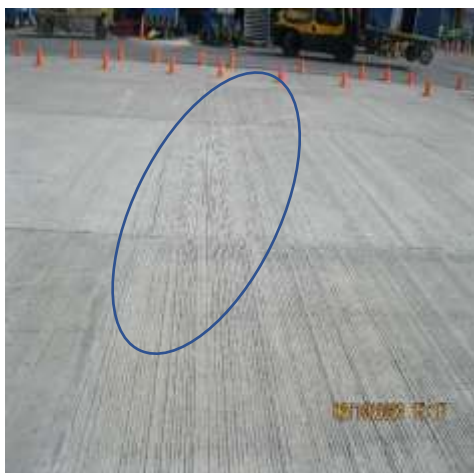
Foto 70. Grieta de esquina
