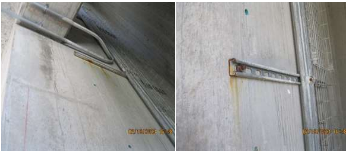
Foto 23 y 24. Efectos de oxidación sobre elementos metálicos
