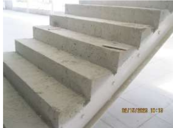
Foto 76. Escalera costado sur, sin enchape y sin barandas de protección
